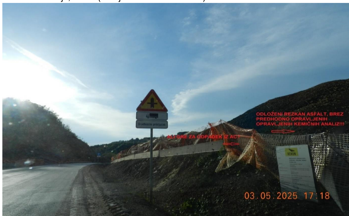
Slika 11; pri tako imenovanem gradbišču lokalne ceste Poljane –Trebelno gre za eno samo nelegalno odlagališče odpadkov, (glej rezkan asfalt) kar omogoča nenadzorovano pronicanje škodljivih snovi v podtalje brez nadzora in prostor za skladišča oz. deponije nelegalno pridobljenega peska
