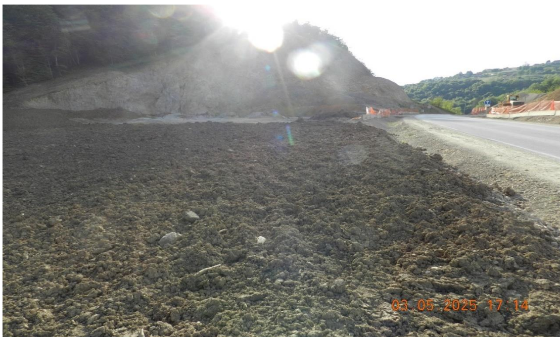
Slika 8; vsi pripeljani gradbeni odpadki izkopna zemljina, asfalti, betoni salonitne kritine so danes zakriti z izkopno zemljino iz lokacije odseka gradnje AC Bič – Trebnje vzhod
